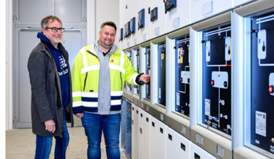
ANDREAS MENNE , Leiter Netzbetrieb Strom (links) und sein Stellvertreter Andreas Holterhoff (rechts) sind voll im Plan bei dem Umspannwerk West.
