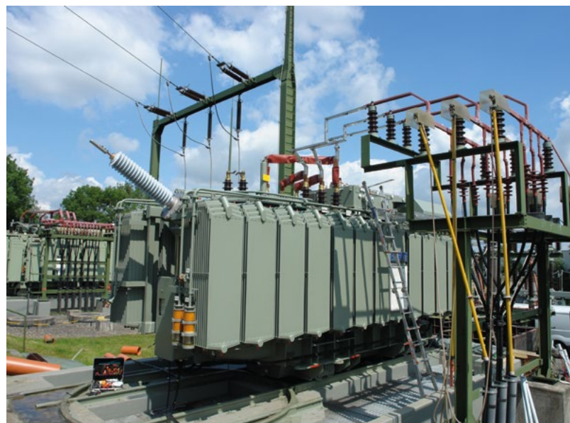
MODERNISIERUNG AUF HÖCHSTER EBENE , 2011 haben die Stadtwerke einen ihrer beiden Trafos auf der 110kV/30kV-Ebene ausgetauscht.
